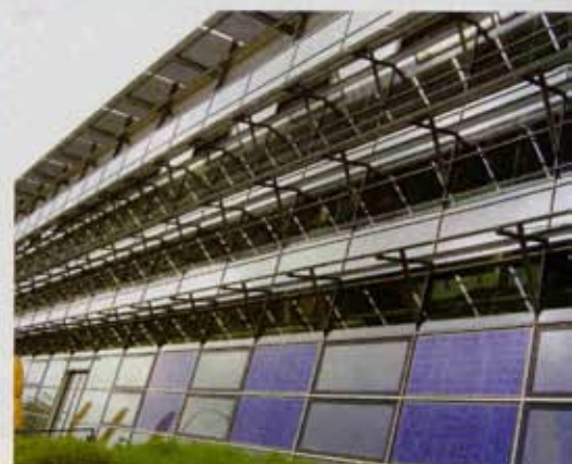
Fotos 4 e 5 – Módulos solares entre placas de vidro
